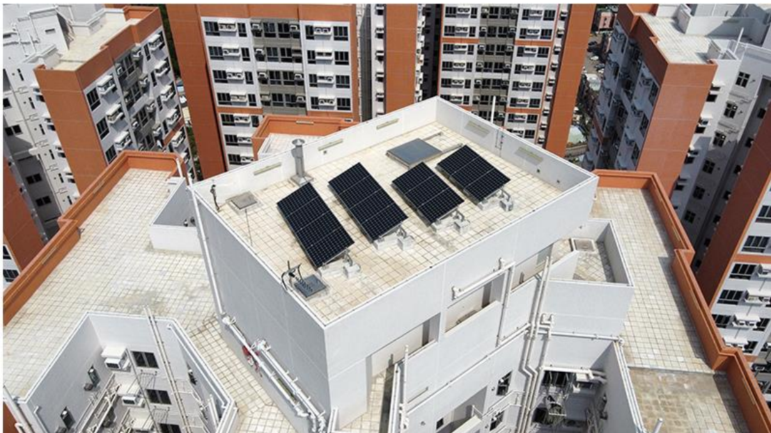
装设于芬园天台的太阳能发电光伏板。
