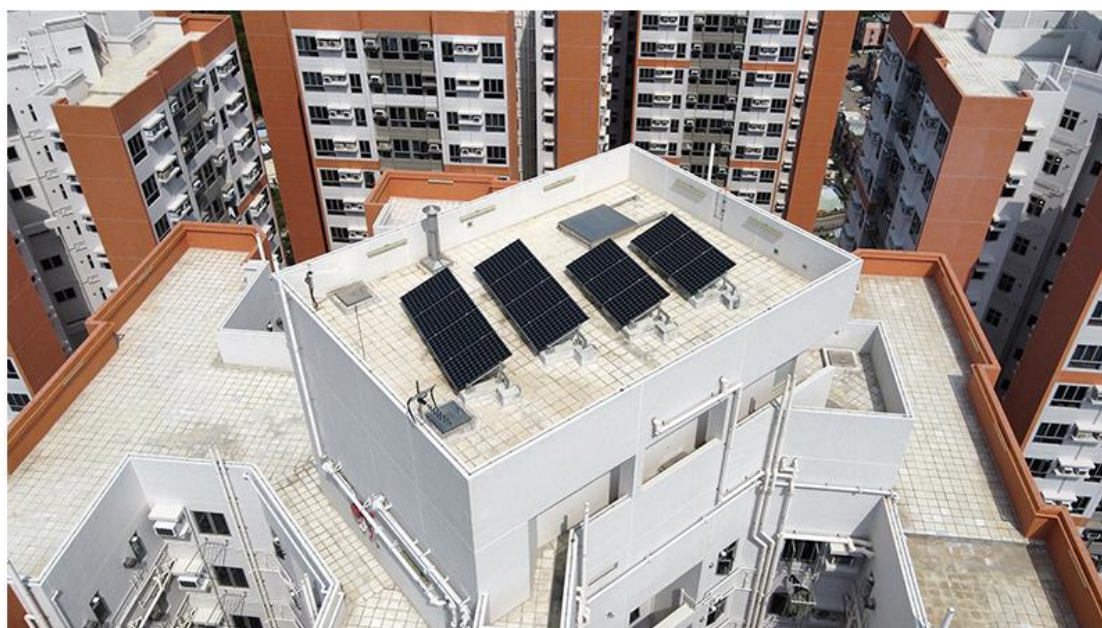
裝設於芬園天台的太陽能發電光伏板。
