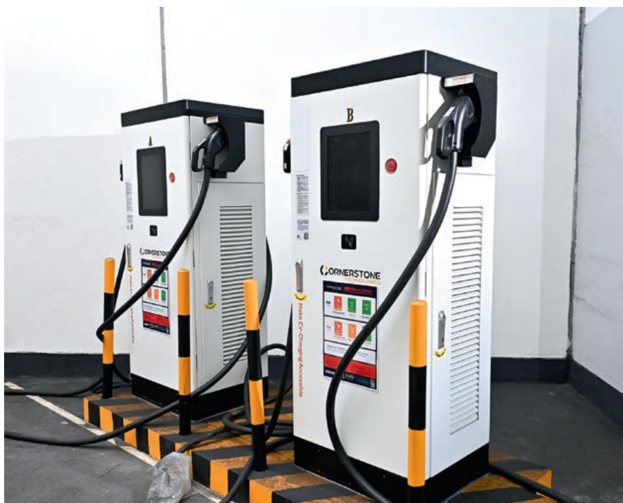
警察總部大樓內的電動車充電站。
