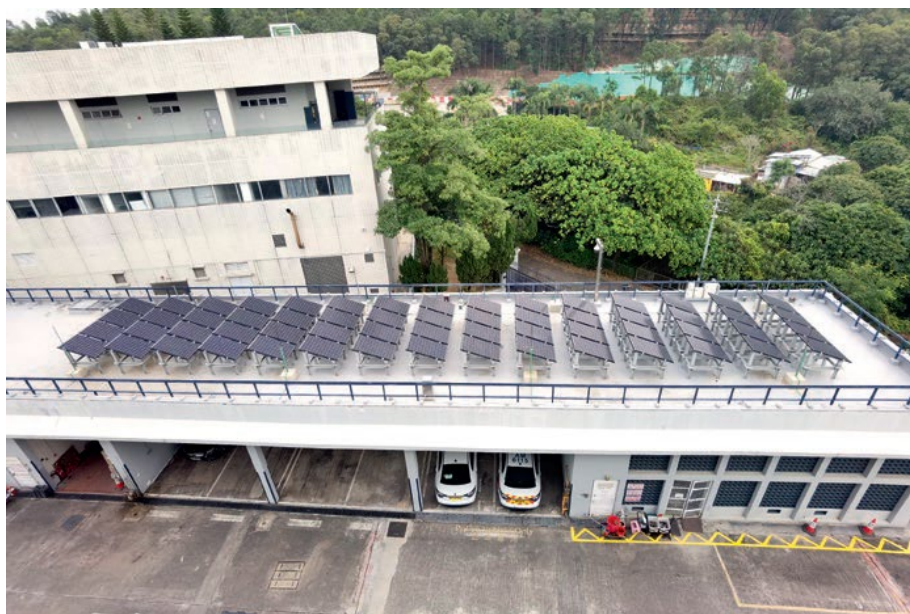
邊界警區總部停車場上方架設光伏板，收集太陽能。
